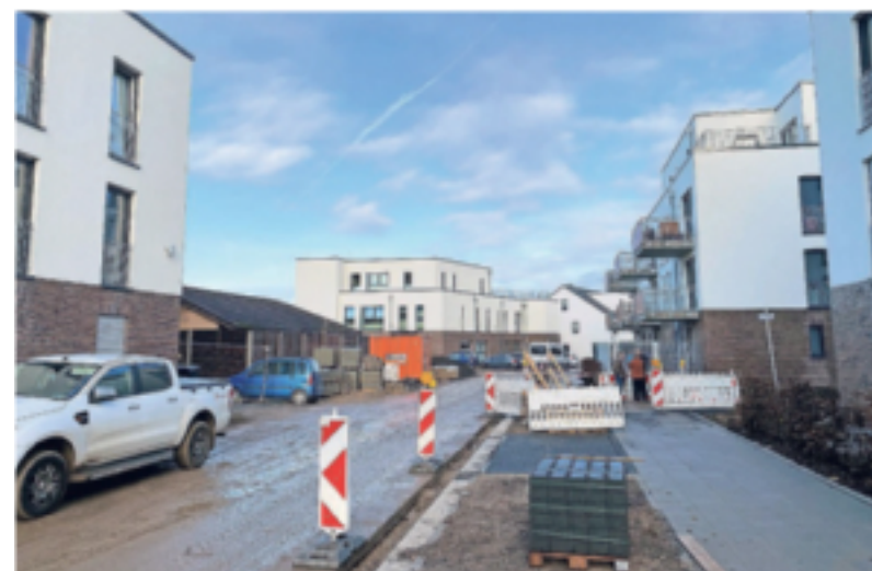
Im Neubaubereich des Quartiers Am Ledenhof sieht man noch eine Baracke (links Mitte), die für den zweiten Bauabschnitt abgerissen wird.
